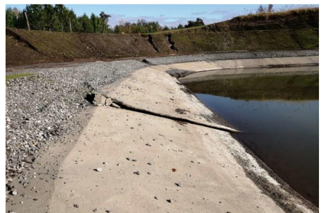
Exemple de désordre sous bassin béton
